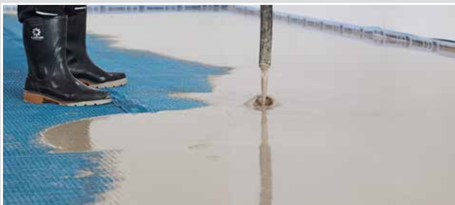
9 Applicera SCHÖNOX HS 50 avjämningsmassa. För större områden rekommenderas att man använder en högeffektblandare och pump.
